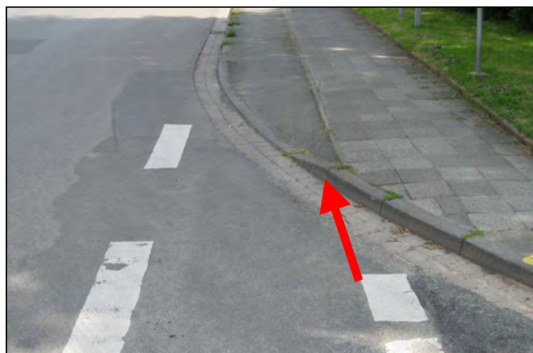
Bild 4-11: Schlecht aufeinander abgestimmte Markierung und baulicher Zustand können zu Stürzen beitragen (L 410)
